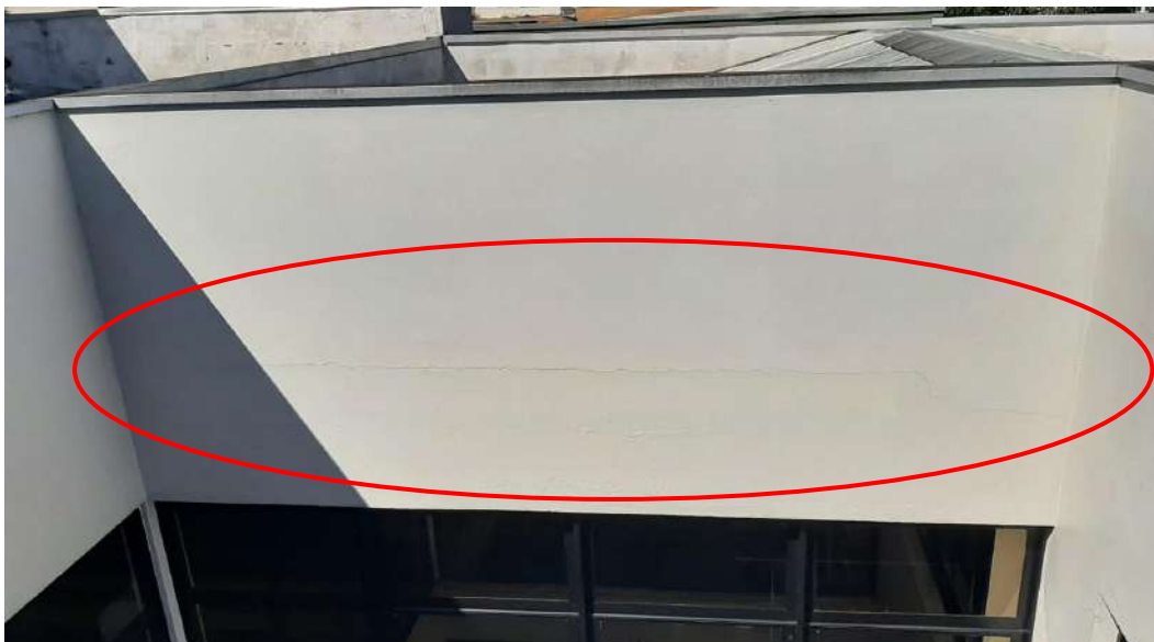
Imagem 3 – Fissuras entre laje de cobertura e alvenaria
