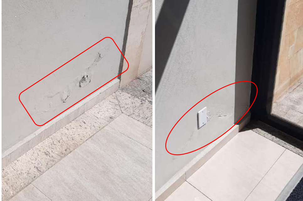
Imagem 14 – Umidade ascendente externa e interna, respectivamente.
