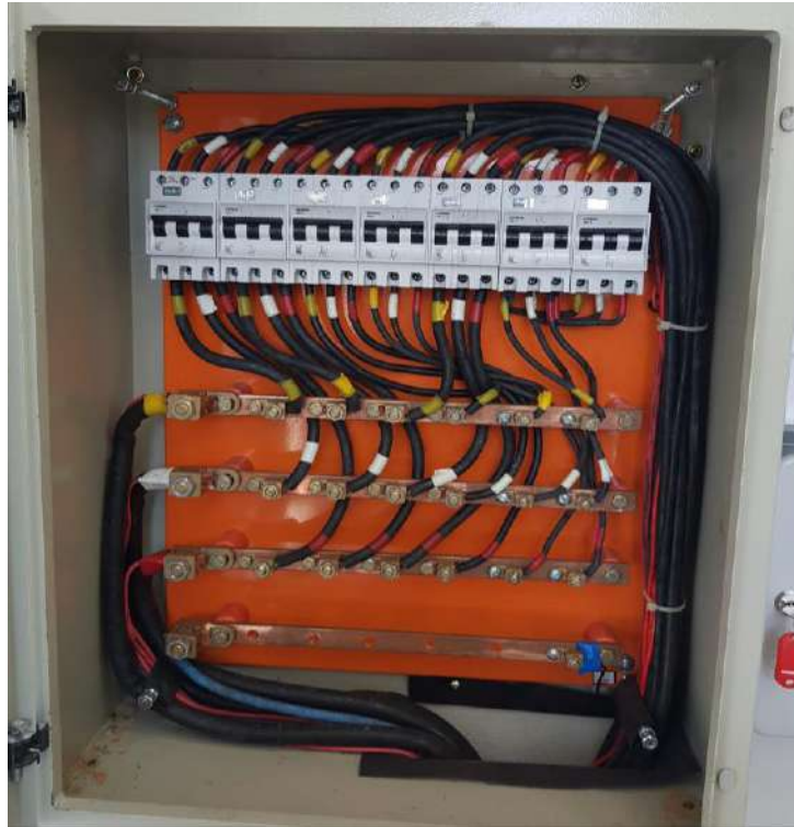
Foto 01 - QGBT existente – Fonte Autor
