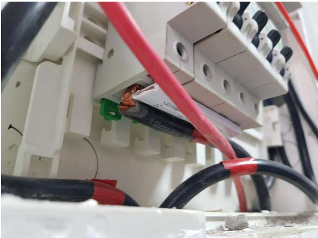
Foto 19 – Cabo cortado pela metade, risco de choques – Fonte Autor
