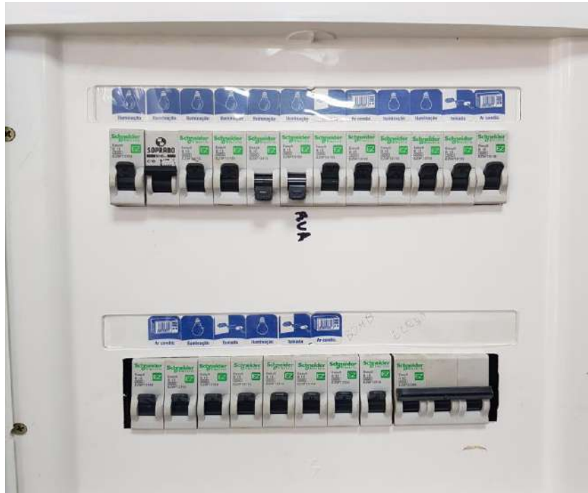
Foto 04 – Quadro 01 Próximo ao QGBT no térreo (externo) – Fonte Autor
