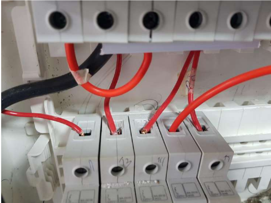
Foto 18 – Jumpers e conexões mal feitas – Fonte Autor
