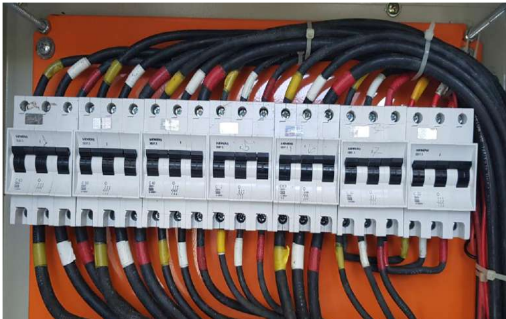
Foto 02 - QGBT existente – Fonte Autor
