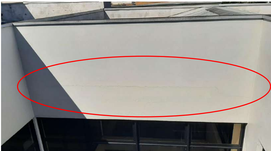
Imagem 3 – Fissuras entre laje de cobertura e alvenaria
