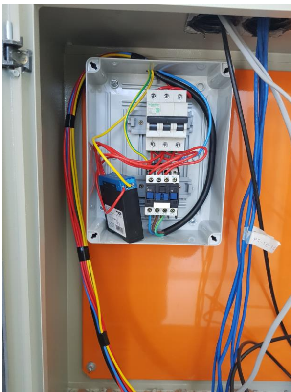
Foto 15 - Quadro ao lado do QGBT – Aparentemente liga a iluminação externa – Fonte Autor
