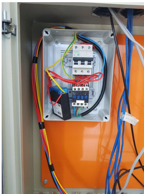
Foto 15 - Quadro ao lado do QGBT – Aparentemente liga a iluminação externa – Fonte Autor
