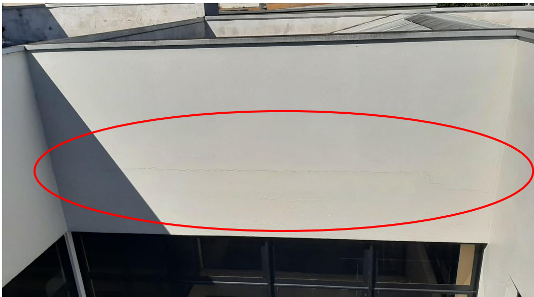
Imagem 3 – Fissuras entre laje de cobertura e alvenaria
