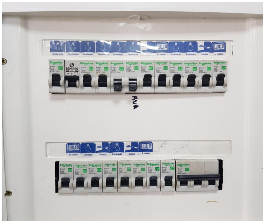
Foto 04 – Quadro 01 Próximo ao QGBT no térreo (externo) – Fonte Autor
