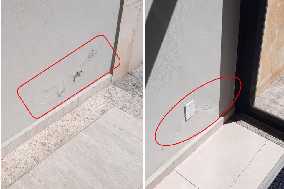
Imagem 14 – Umidade ascendente externa e interna, respectivamente.
